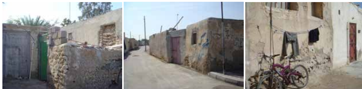
تصویر ۵: فرسودگی کالبدی شدید در محله
