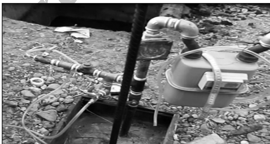
شکل ۱۱- تجهیزات اندازه گیری دبی
